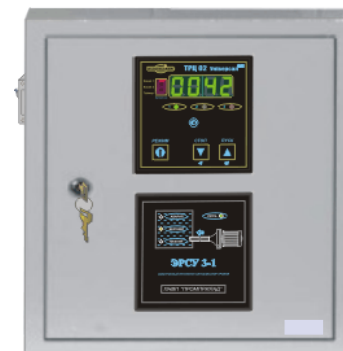
Щит управления шкафом растойки теста (контроль температуры и влажности воздуха в камере + поддержание уровня воды в емкости испарителя)
